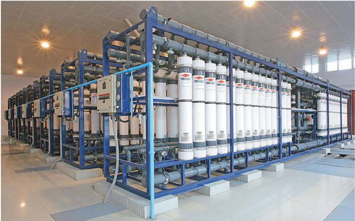
شکل ۹ - نصب دستگاه DOW UF با استفاده از مدول‌های ۲۸۶۰
